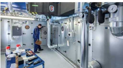
Überprüfung der RTL-Anlage.
