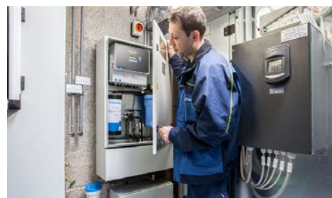
Funktionsprüfung der Befeuchtungseinrichtung.
