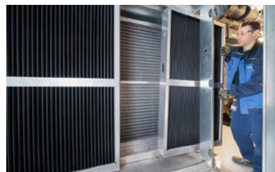
Überprüfung der Zugänglichkeit der Tropfenabscheider
