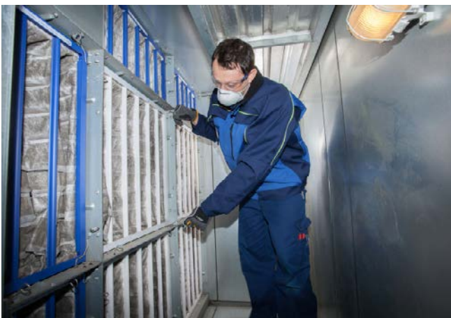
Hygienekontrolle der Luftfilter einer RLT-Anlage
