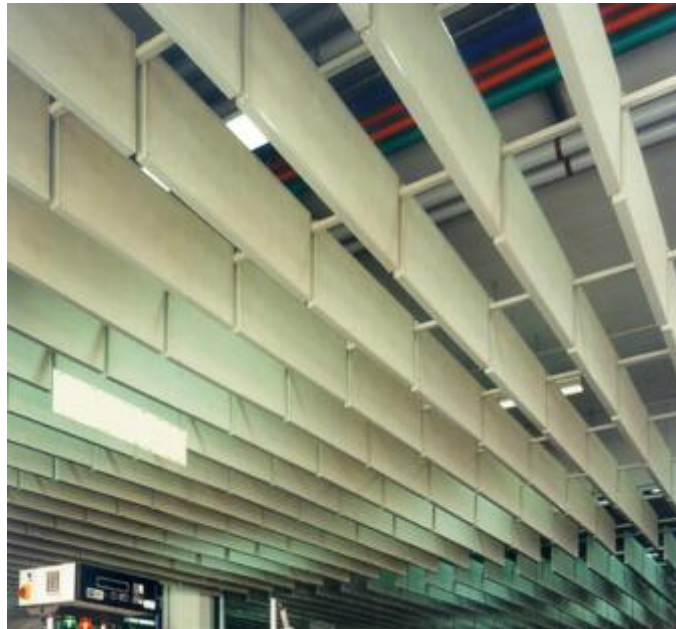
Deckenverkleidung mit Baffles
