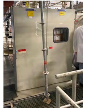
Mit Gerüst dauerhaft verstellter Zugang zu elektrischen Betriebsmitteln
