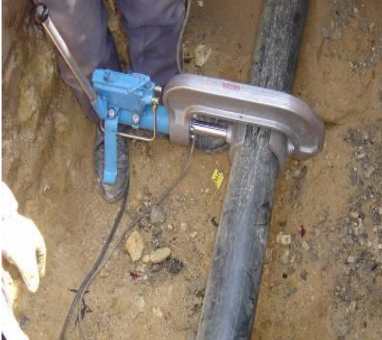
Rückrundung der gequetschten PE-Rohrleitung
