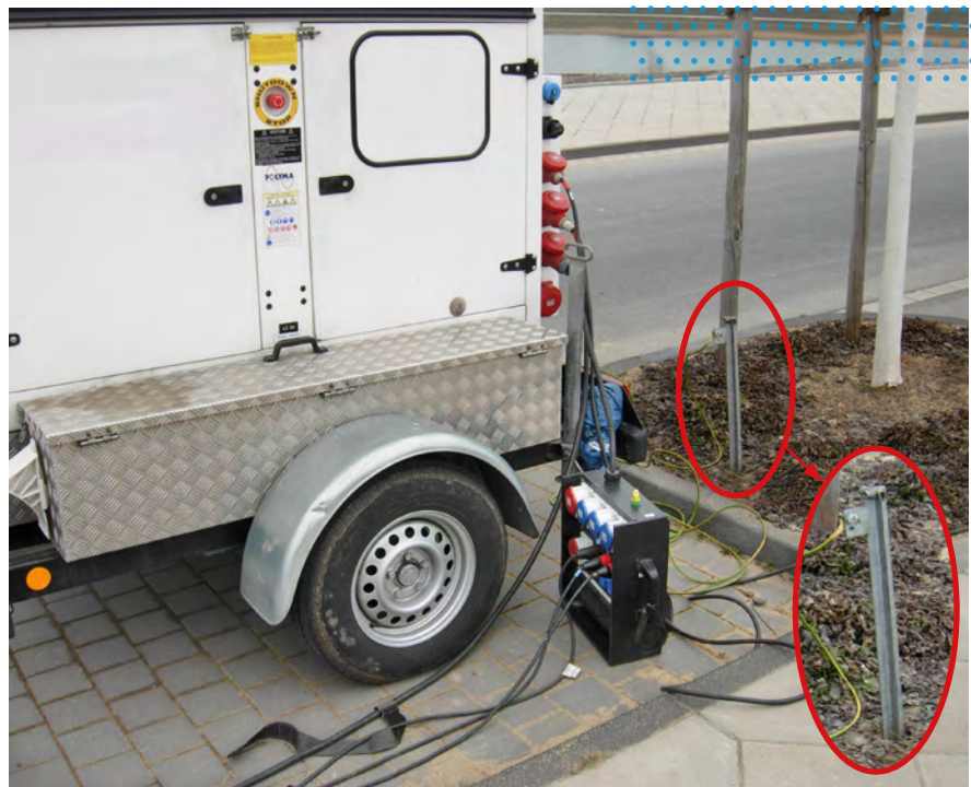
Stromerzeuger mit mobilem Stromverteiler und Erdspieß
