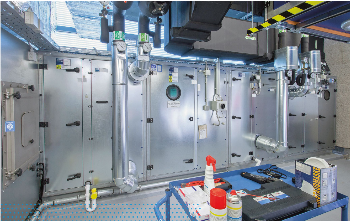
Bauelemente in der Lüftungszentrale müssen gefahrlos zugänglich sein
