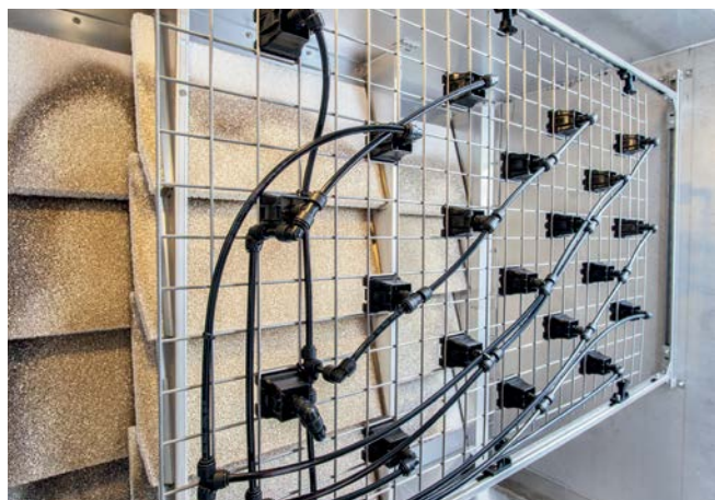
Zentrale Luftbefeuchtung in der RLT-Anlage
