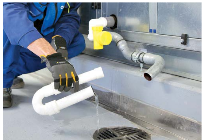
Kondensatwasserentleerung aus einem Syphon
