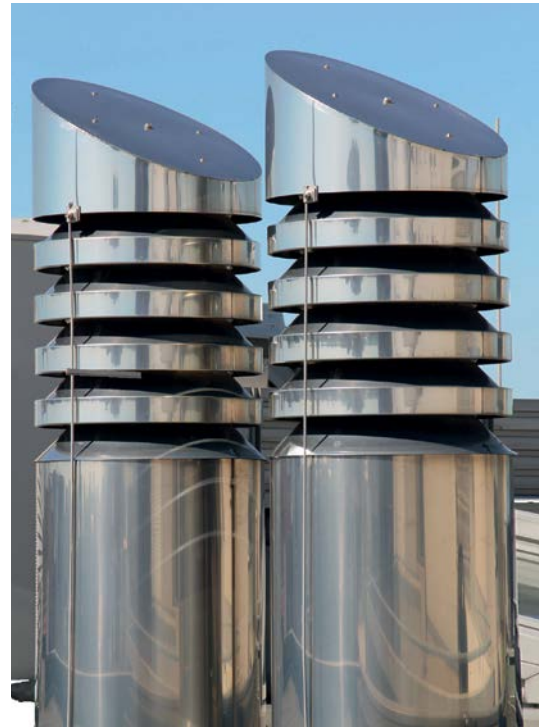
Außenluftansaugöffnung auf dem Dach
