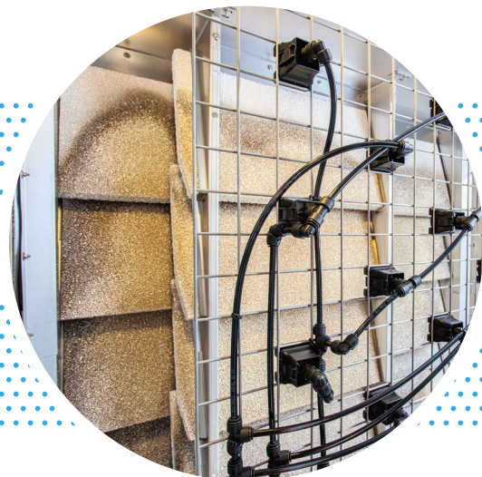
Zentrale Luftbefeuchtung in der RLT-Anlage
