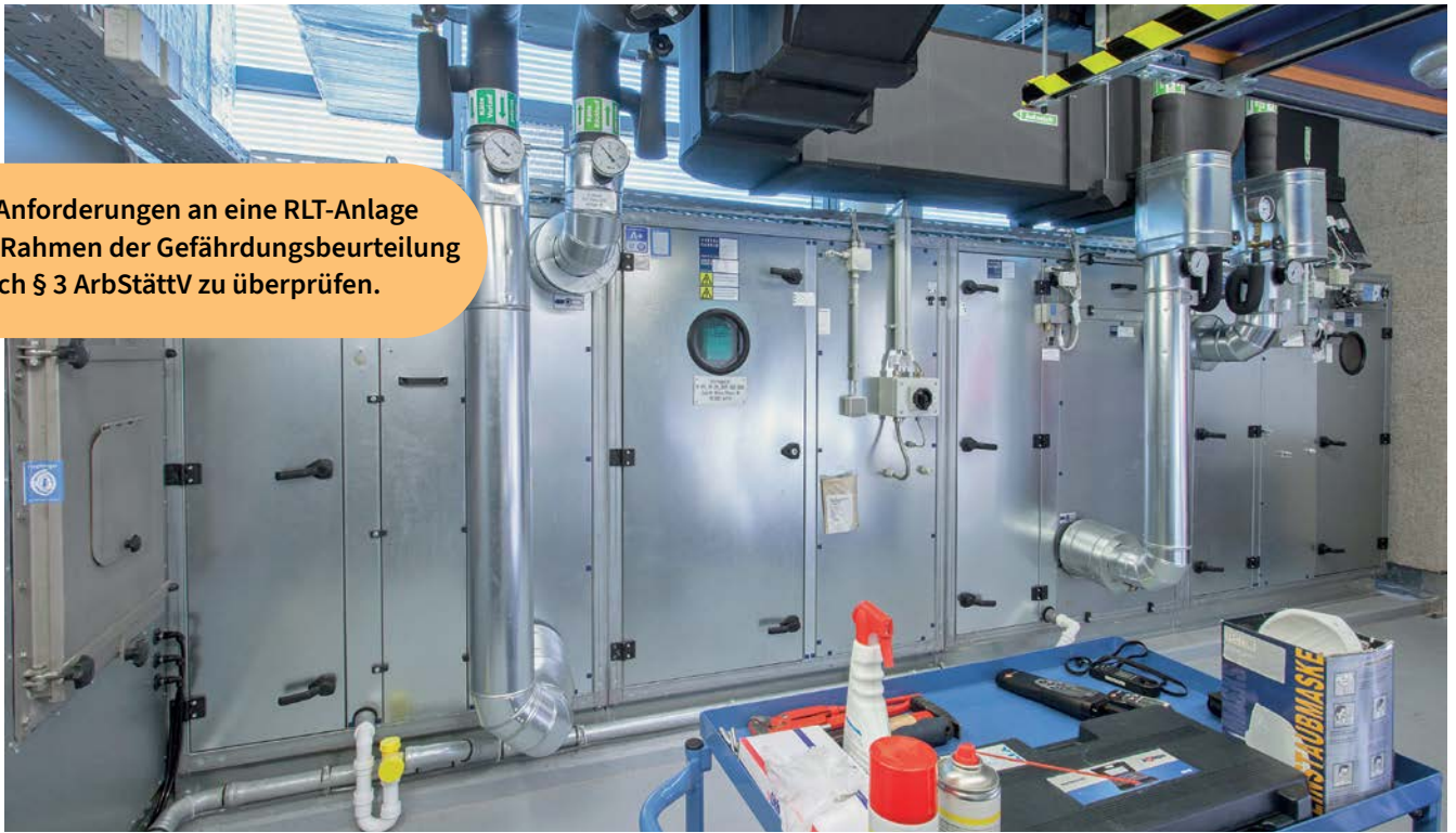
Bauelemente in der Lüftungszentrale müssen gefahrlos zugänglich sein.
