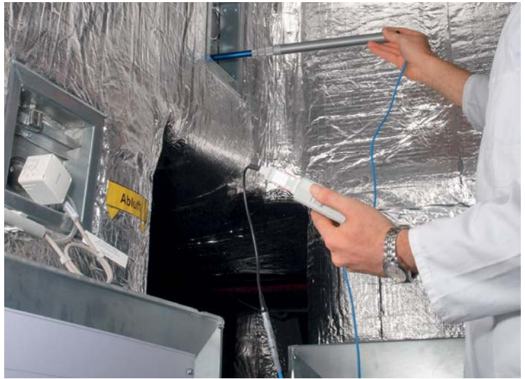
Messung des Luftvolumenstromes in einer Luftleitung
