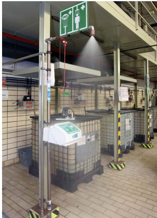
Abb. 13: Kombinierte Not- und Augendusche in einem Arbeitsbereich mit Verätzungsgefahr
