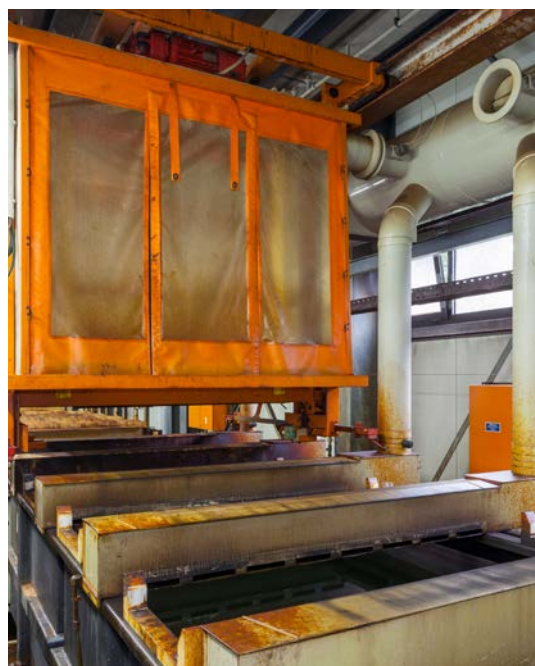
Abb. 12: Automatische Anlage mit Lüftungskabine am Transportwagen und beidseitige Randabsaugung
