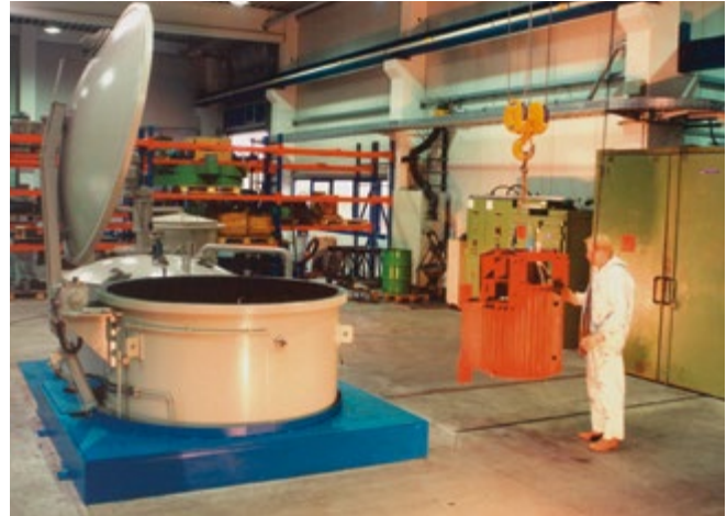
Abb. 13: Vorbildliches Arbeitsumfeld beim Betrieb einer Vakuumtränkanlage
