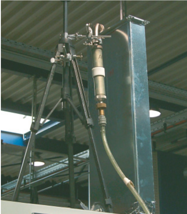
Abb. 7: IPS in der Reinluft hinter einem Abscheider
