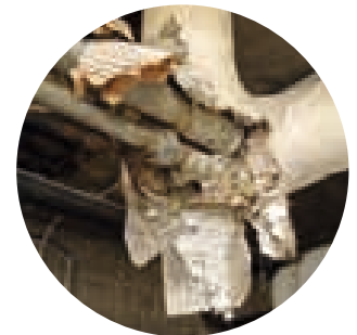
hoher Asbestanteil = viel Asbest, wenig Bindemittel
